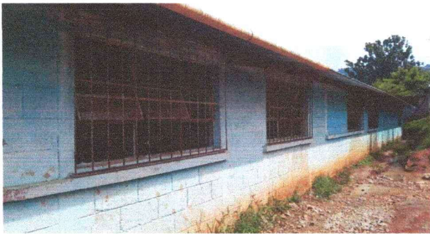
Foto 3: Se observa que se necesita mantenimiento de todo los balcones y pintura de pared exterior.
